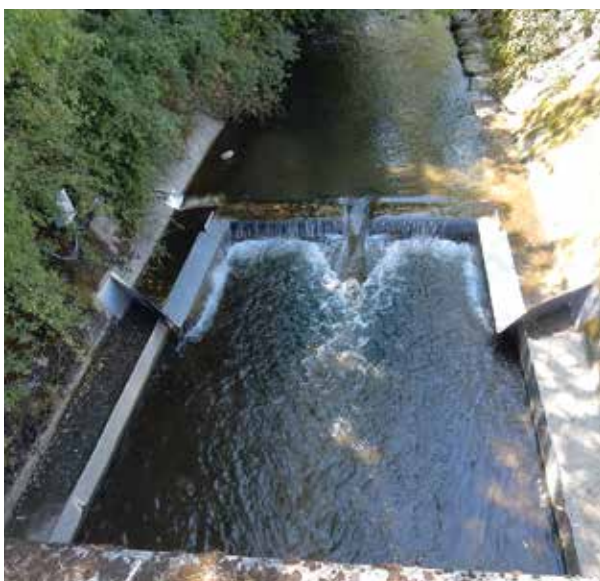
Abb. 5: Krebssperre im heutigen Zustand mit den beidseitig angebrachten Blechen, die die Umwanderung über die Bermen verunmöglichen soll
