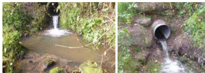
Abb. 11: Maßnahme am Heubach: Anbringen einer Stahlmanschette mit Überkrragung im Rohr zur Optimierung der Schutzwirkung (vorher/nachher)
